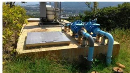
銅鑼園區污水處理廠中水系統-景觀噴灌水池
