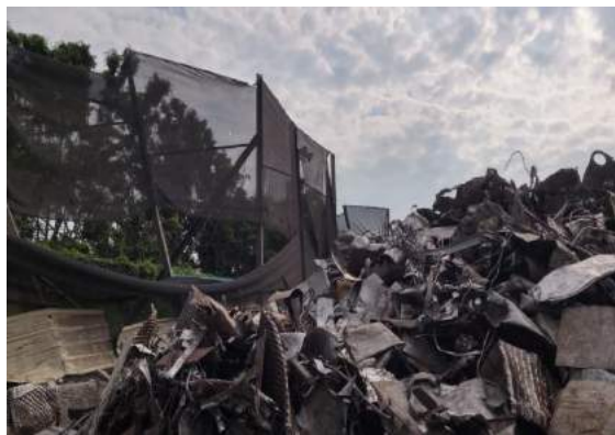
堆置場阻隔牆損壞
