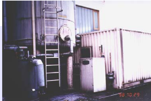
貯槽左下方為粗篩，右邊貨櫃屋為廢水處理設施
