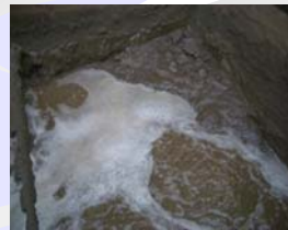
未設沉砂池處理單元累積大量污泥
