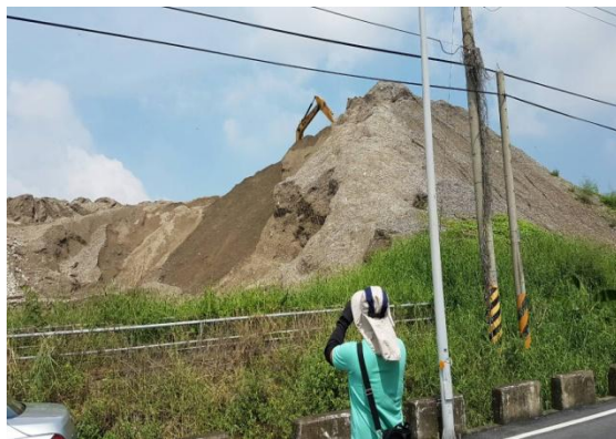
堆置場無防制措施
