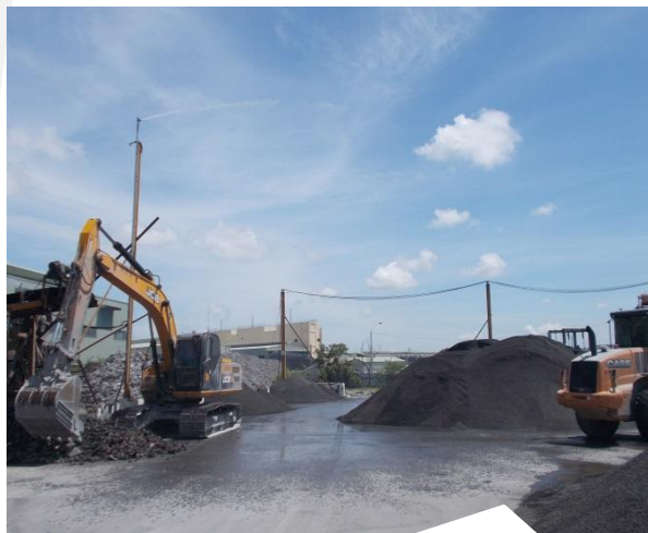
堆置場皆未達覆蓋面積80%
