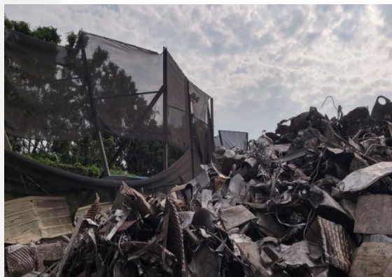
堆置場阻隔牆損壞
