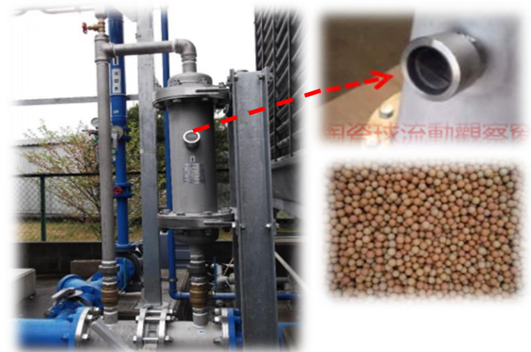
某工廠冷卻水塔設置陶瓷球旁濾系統
