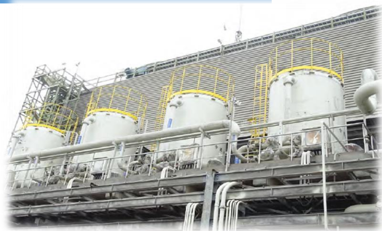
某汽電共生廠冷卻水塔設置旁濾系統
