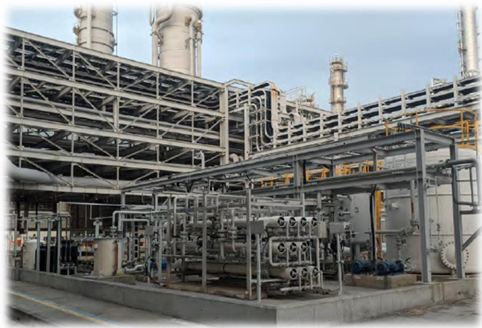
某石化廠冷卻水塔排放水以MMF+RO系統回收
