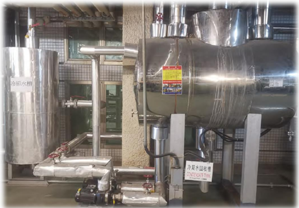
某生醫材料廠鍋爐冷凝水回收
