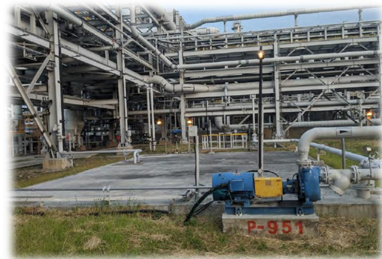
某石化廠雨水回收
