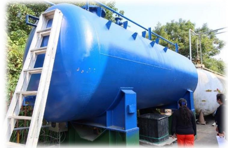
某工業區污水廠放流水回收給材料廠作為製程冷卻水(50 CMD)
